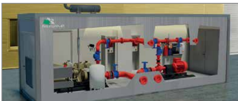
Esempio di gruppo antincendio installato
