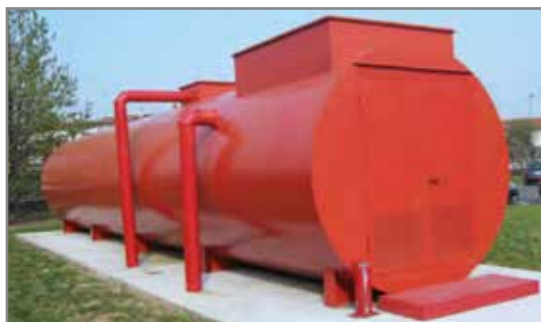
Esempio di sistema antincendio installato
