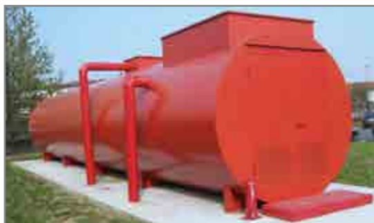
Esempio di sistema antincendio installato
