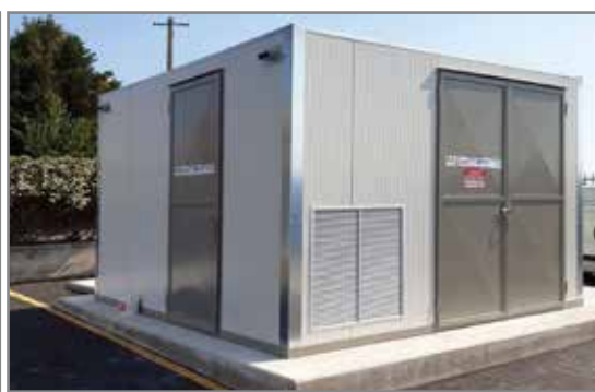
Esempio di locale tecnico installato
