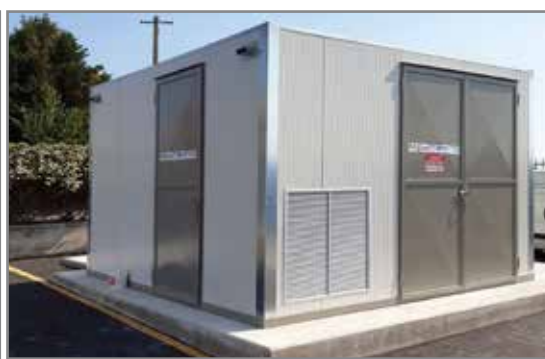
Esempio di locale tecnico installato
